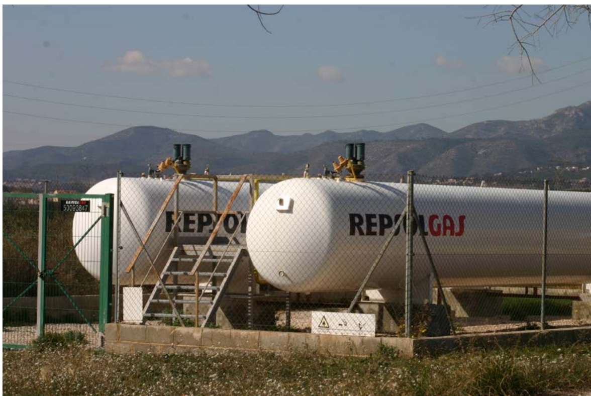
Foto n°96. Dipòsits de gas – probablement propà – situats a tocar del límit est del casc urbà de Banyeres.
